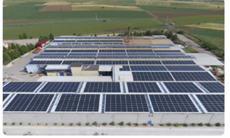
Akpamuk GES - Uşak - Tekstil - 910 KWp
